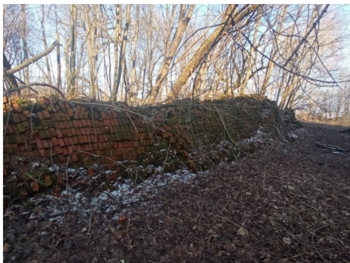
Fot. 11. Stos cegieł znajdujący się przy północnej ścianie dworku [fot. M. Dudkiewicz 2021] Photo 11. A pile of bricks by the northern wall of the manor house [photo M. Dudkiewicz 2021]
