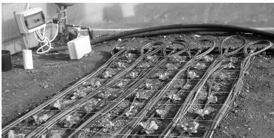
Fig. 3. Heating system inside the greenhouse Rys. 3. System grzewczy wewnątrz szklarni
