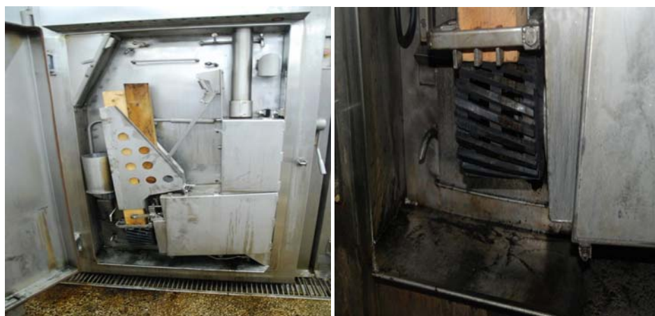
Rys. 1. Urządzenie do wytwarzania dymu wędzarniczego metodą tarcia drewna zainstalowane w komorze wędzarniczej w ZPM WiR w Łopusznie (fot. L. Krala)
